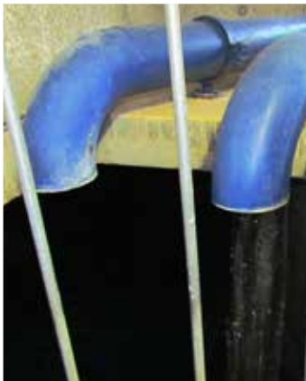
Arrivée de l'eau dans le réservoir, à gauche chez Grillet, à droite source de l'Adieu
