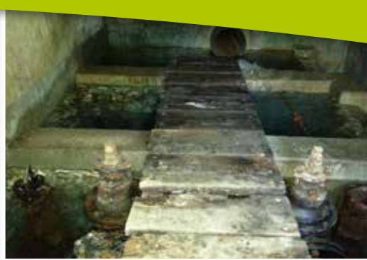
Chambre de distribution
