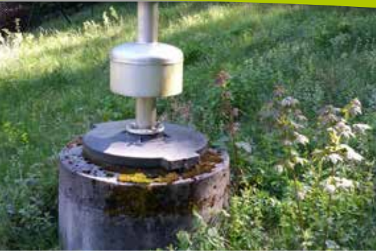
Aération de la chambre de captage
